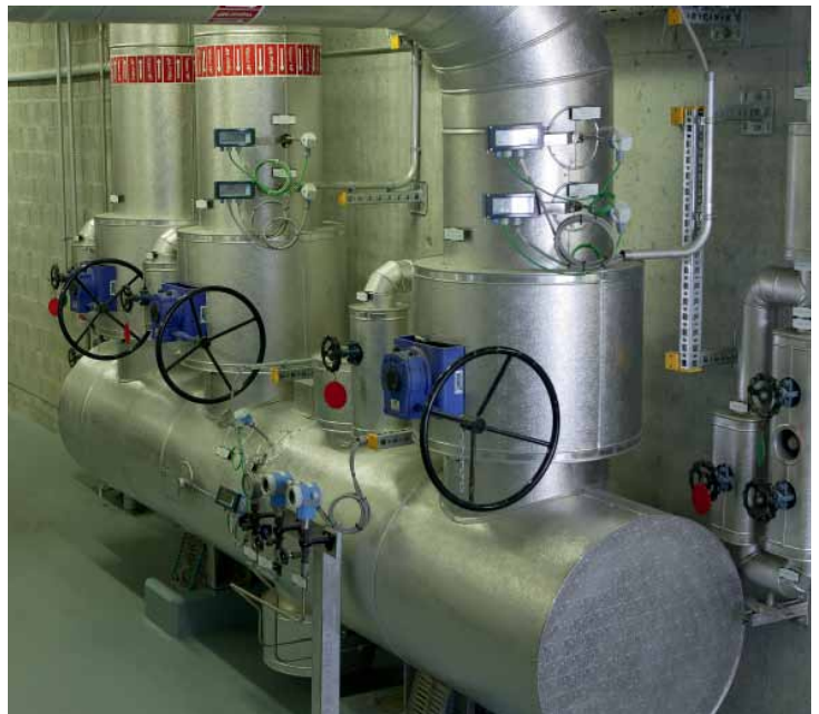
Redundantní měření tlaku na rozváděči vysokotlaké a středotlaké páry a redundantní měření teploty na hlavním přívodu.
